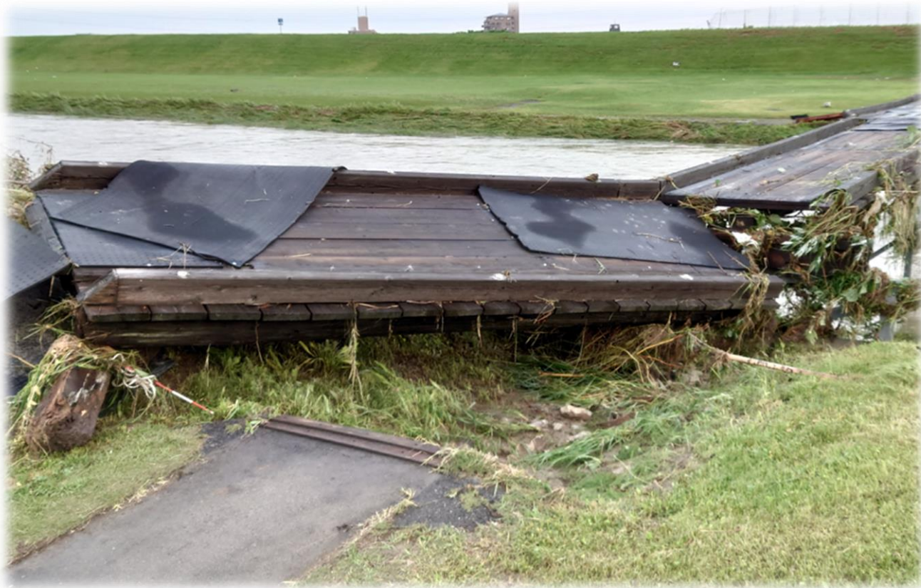
18番橋入口（一部崩壊）
