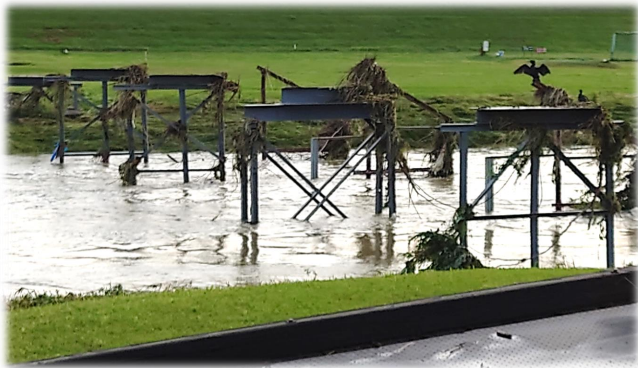
13番橋（全面崩壊）
